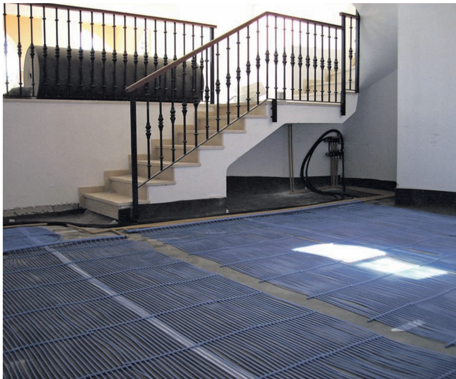
Energiesparender verhalten sich Kapillarrohrmatten als Fußbodenheizung.
