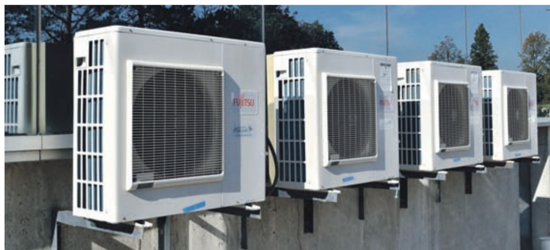
Ein übliches Bild in südlichen Ländern: Klimaanlage.
